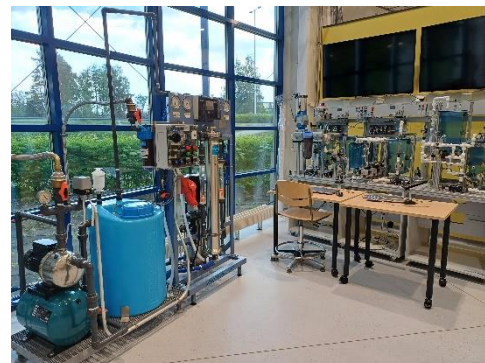
Koulukatu 5E prosessi- ja laboratorioalan vedenpuhdistin vasemmalla ja Feston automaatiojärjestelmä oikealla.
